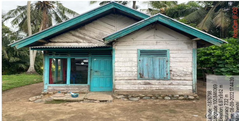
Rumah Tidak Layak Huni (Sebelum di rehabilitasi)
